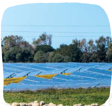
Parc photovoltaïque en pâturage ovin
