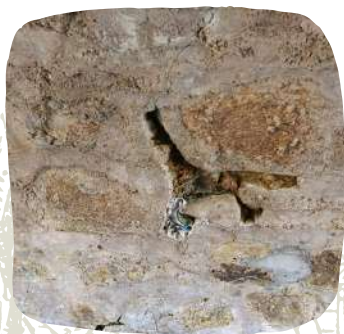
Disjointements, fissures entre pierres, briques, etc
